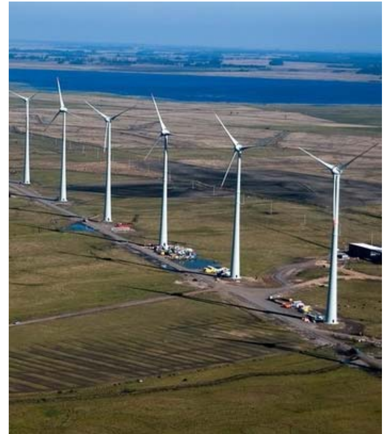
Osório Windpark, Bundesstaat Rio Grande do Sul 75 x E-70/2000 kW = 150 MW, 98 m Betontürme Betreiber: Ventos do Sul/Enerfin/Elecnor Stromabnehmer: Eletrobrás/CEEE
